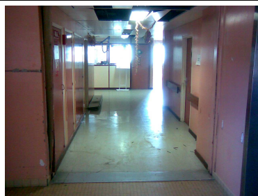
Fig 8. Chute de faux-plafonds
