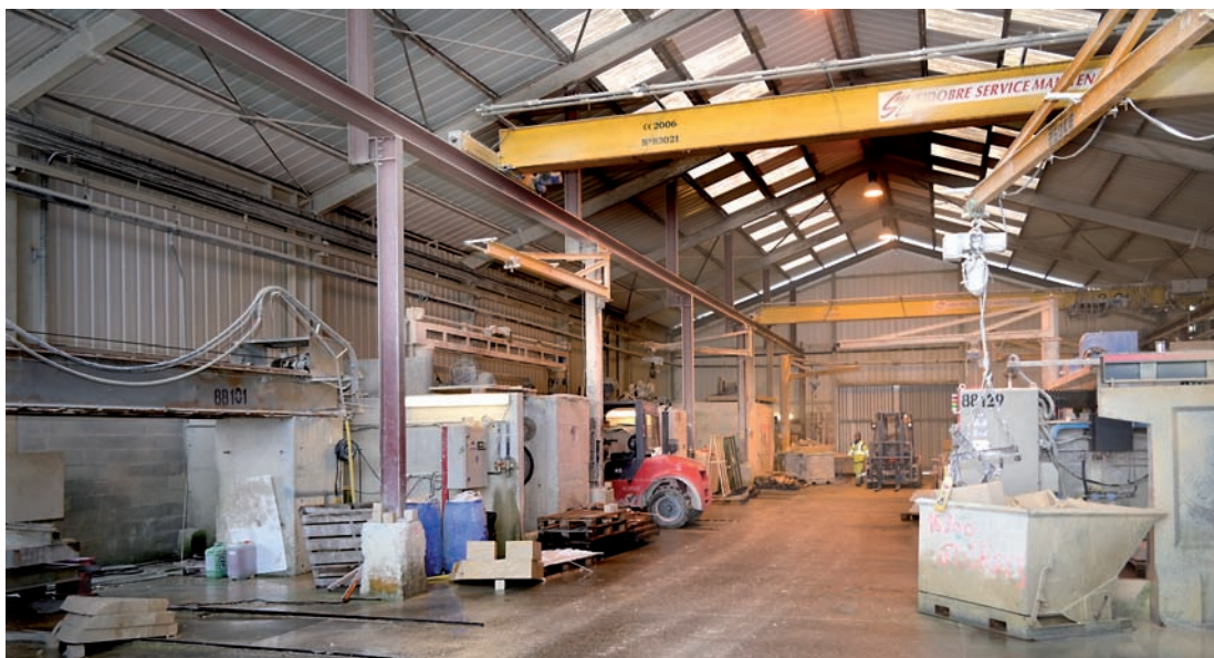
Vue partielle de l’atelier dans lequel sont installées huit débiteuses automatiques de 1 m à 2 m de Ø et deux débiteuses/fraiseuses numériques. Le sciage primaire est assuré par un monolame BM et le monofil programmable Pellegrini.
