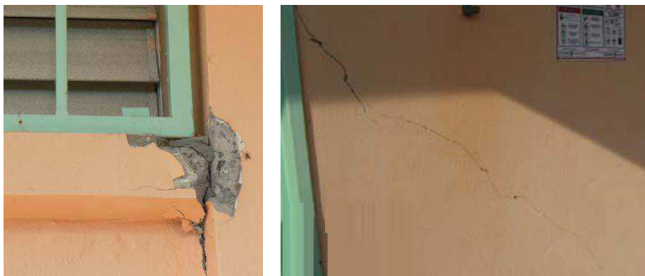
Domages suite au séisme de novembre 2007
